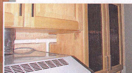
«Туннель» в боковых стенках шкафа позволил замаскировать газовую трубу.
